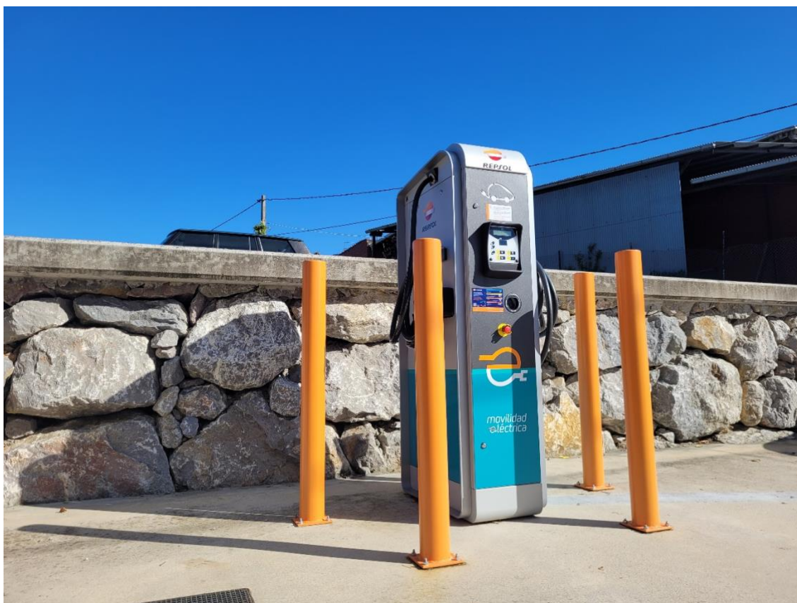
Imagen del equipo de 50kW instalado en el margen dirección Getxo
